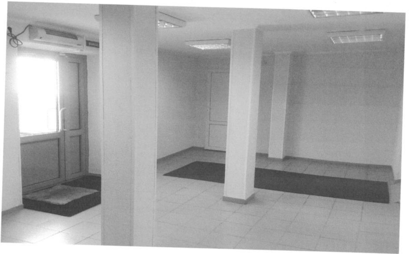
Фото № 8 вход в тамбур здания ул. Победы ,дом 4
