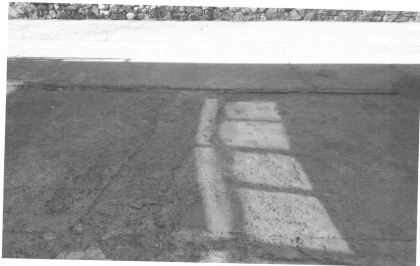
Фото №7 асфальт перед центральным входом в здание ул. Победы ,дом 4
