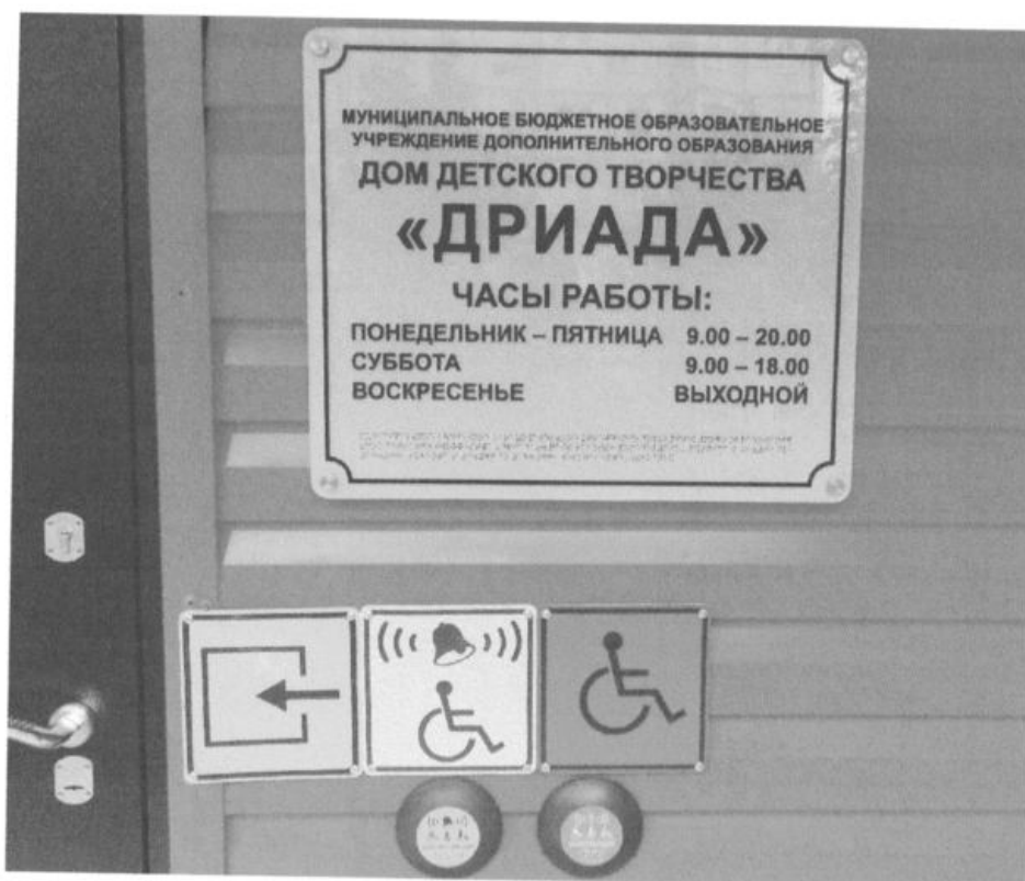
Фото № 10 вход в здание № 1: кнопка вызова персонала, кнопка включения звуковой информации, тактильные указатели и вывеска, ул. Октябрьская, дом 12.
