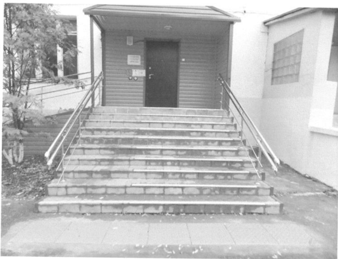
Фото № 2 вход(запасный) в здание № 2, пандус ул. Октябрьская, дом 12.
